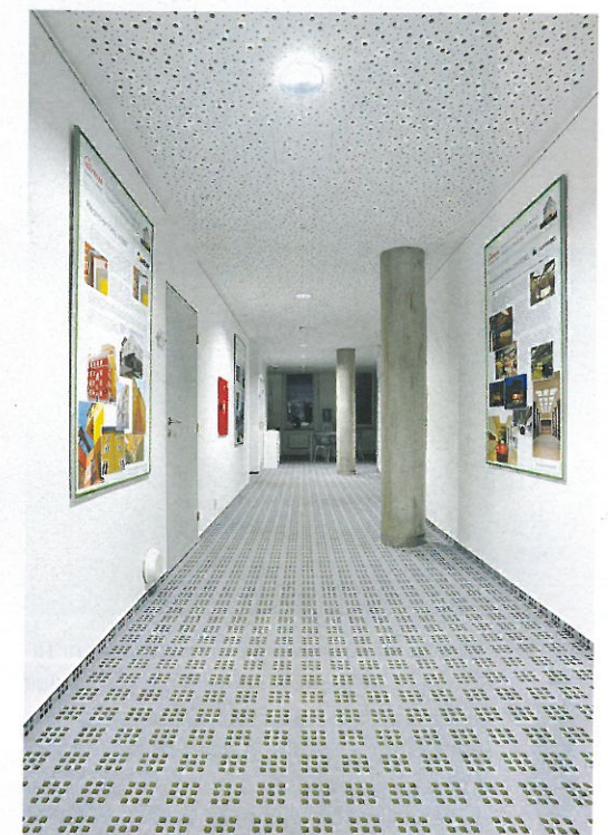
Das Luxmate-Lichtmanagementsystem übernimmt bei Bedarf auch die Steuerung der Beleuchtung in den Gängen und Stiegenhäusern – im Bild die FD-1000-Downlights.
