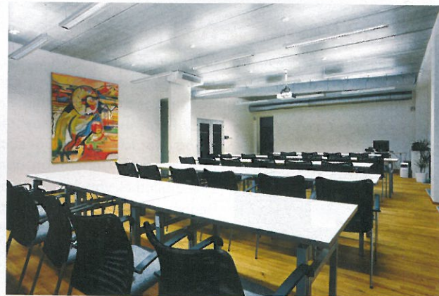
Der Lehrraum ist mit Zumtobel Rasterleuchten Eleea ausgestattet – sie zeichnen sich durch einen sehr guten Wirkungsgrad und hohen Blendfreiheit aus.
